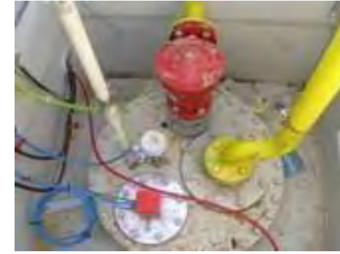
Boca de llenado
