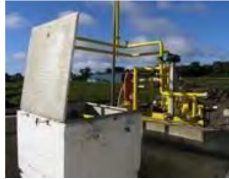
Boca de llenado
