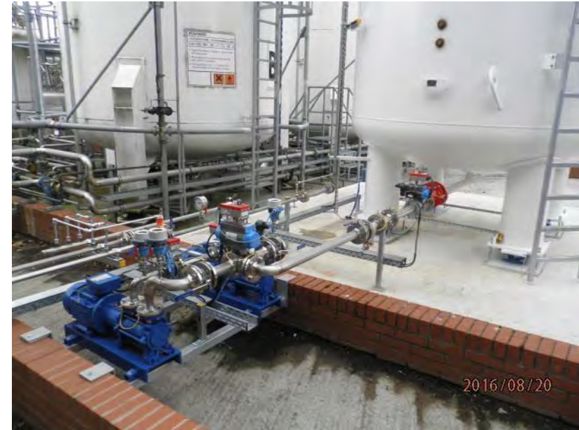
Bomba de transferencia
